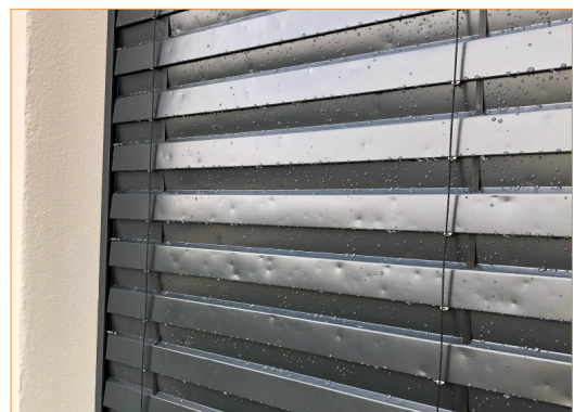
Capacité de résistance de la façade à la grêle Lamelle inadaptée à la grêle.
